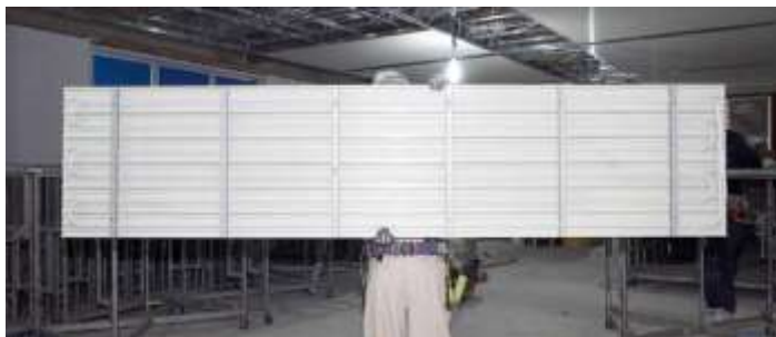
Tubulação passa dentro do forro
